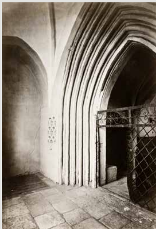
Tiiliportaali ennen korjausta. HK
